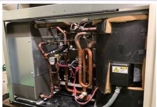
上画像：工場内で運用中の冷水チラー熱交換器
